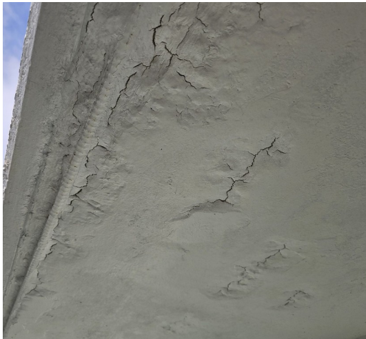
처마 하부 도막 박리·균열
