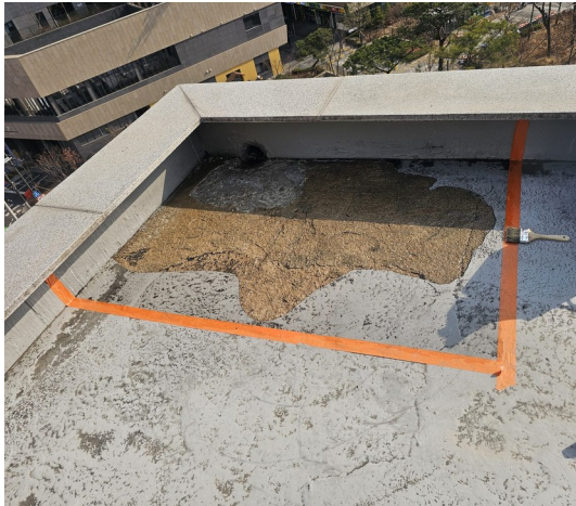
시공 전 — 들뜨고 갈라진 기존 방수층
